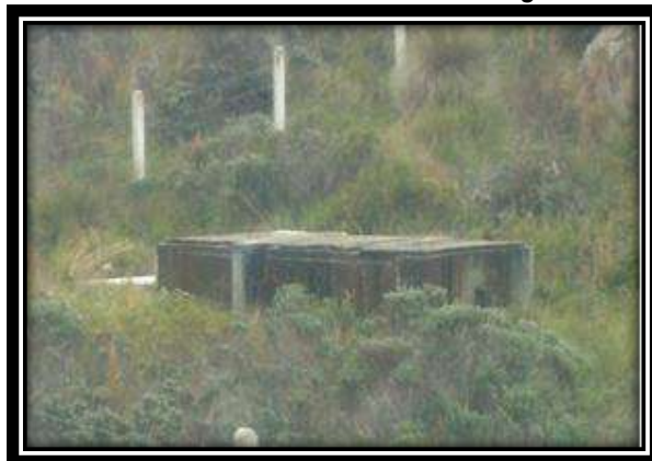
Ilustración 52. Desarenador- Sistema Aguas Claras
