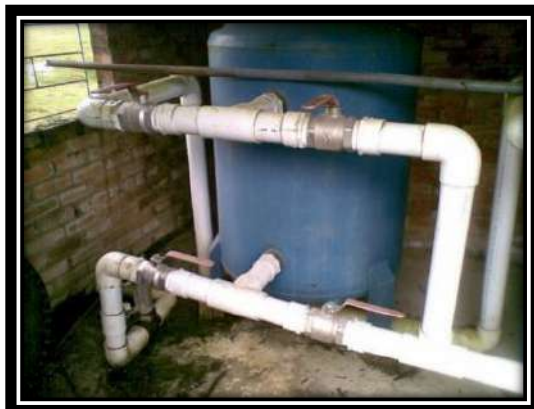
Ilustración 13. PTAP existente Acueducto Veredal ASOMEDIANARANJA
