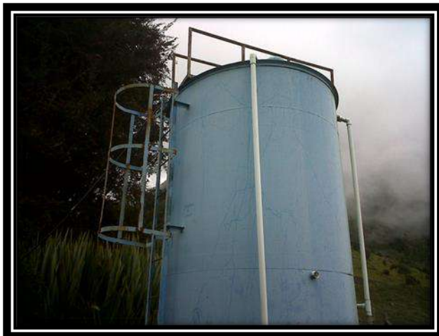
Ilustración 27. Planta de Potabilización Acueducto Veredal ASOPERABECA III
