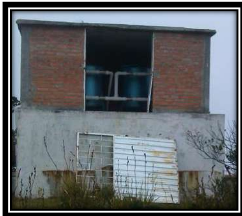
Ilustración 71. Tanque de Almacenamiento existente Acueducto Veredal de Brisas del Gobernador
