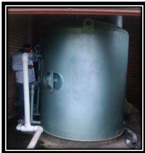
Ilustración 48. Planta de Tratamiento- Sistema San Juan
