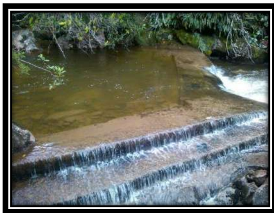
Ilustración 16. Bocatoma existente Acueducto ASOPERABECA I
