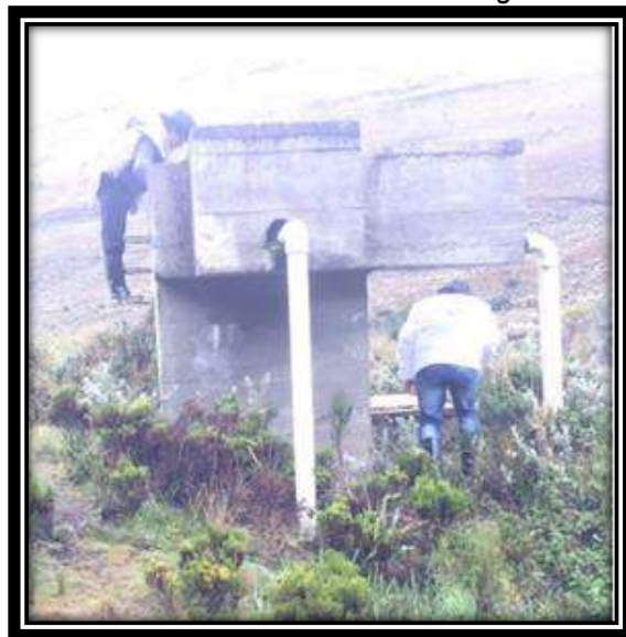
Ilustración 58. Desarenador- Sistema Amigos del Páramo
