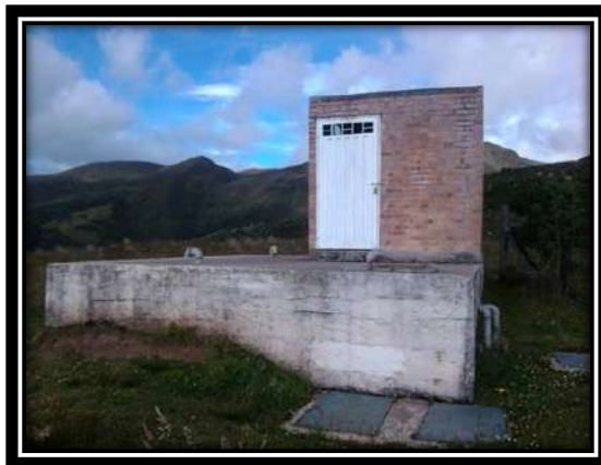
Ilustración 75. Tanque de Almacenamiento existente Acueducto Veredal Tunales/ El Espejo
