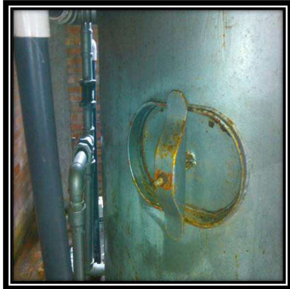
Ilustración 31. Planta de Potabilización existente- Sistema Jericó Acueducto Veredal ASOUAN
