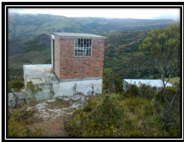
Ilustración 66. Tanque de Almacenamiento existente Acueducto Veredal de Las Vegas Chorreras
