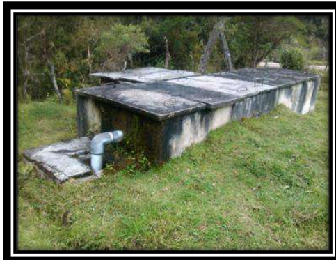
Ilustración 17. Desarenador existente Acueducto ASOPERABECA I
