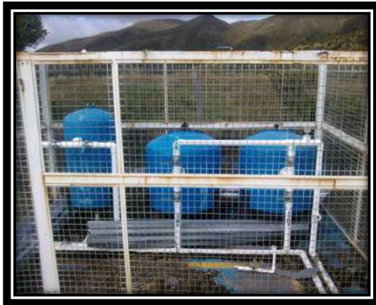
Ilustración 74. Planta de Tratamiento existente Acueducto Veredal Tunales/ El Espejo
