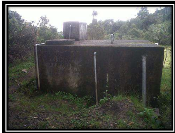
Ilustración 34. Tanque de Almacenamiento Paramillo- Acueducto Veredal ASOUAN
