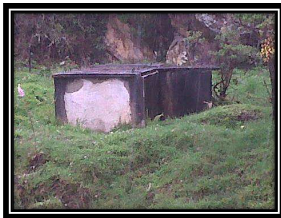
Ilustración 22. Desarenador existente Acueducto ASOPERABECA II
