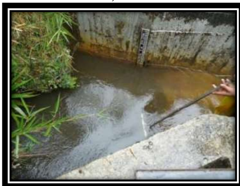
Ilustración 7. Bocatoma Existente, Acueducto Veredal Ríos- Las Palmas
