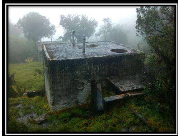
Ilustración 30. Desarenador existente Acueducto Veredal ASOUAN
