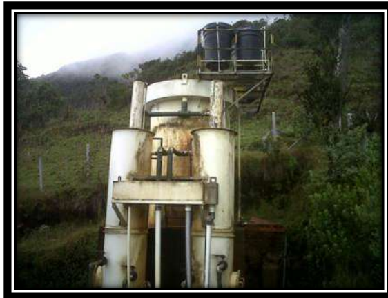
Ilustración 23. Planta de Tratamiento existente Acueducto ASOPERABECA II
