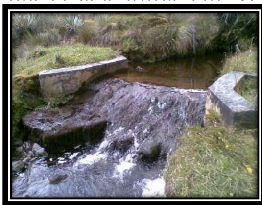
Ilustración 11. Bocatoma existente Acueducto Veredal ASOMEDIANARANJA
