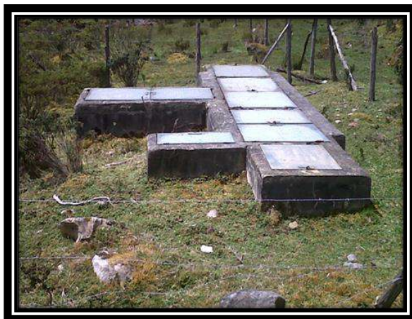
Ilustración 26. Desarenador existente Acueducto Veredal ASOPERABECA III
