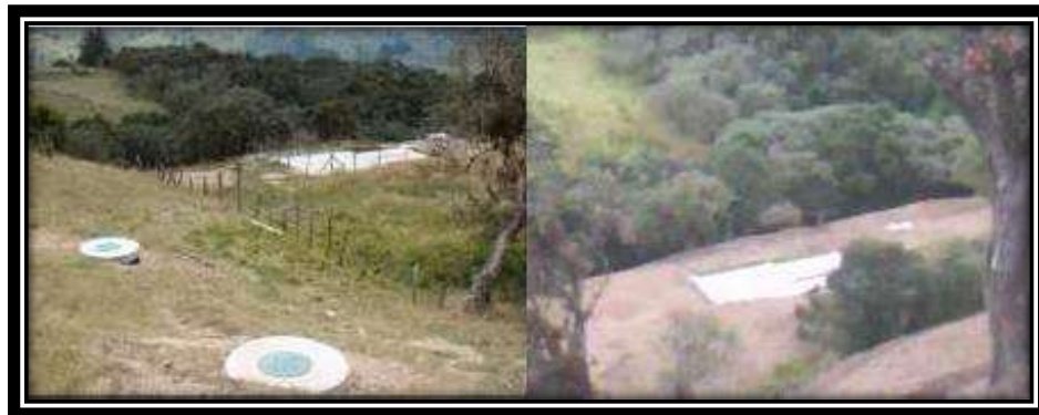
Ilustración 86. Alcantarillado San Juan
