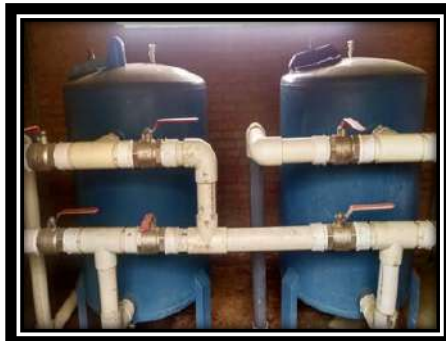
Ilustración 18. Planta de Tratamiento existente Acueducto ASOPERABECA I
