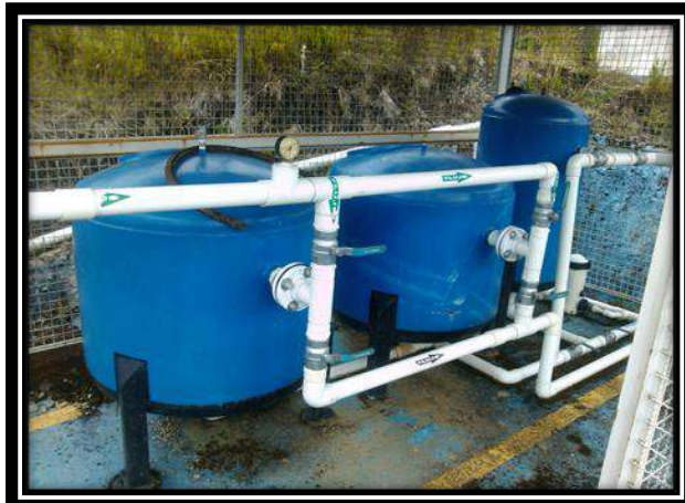
Ilustración 65. Planta de Tratamiento existente Acueducto Veredal de Las Vegas Chorreras
