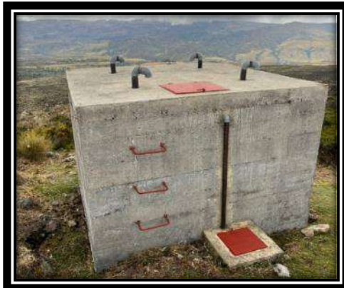
Ilustración 80. Tanque Almacenamiento existente Acueducto Veredal Plan de Sumapaz
