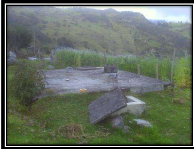
Ilustración 36. Tanque de Almacenamiento Alto La Mira Acueducto Veredal ASOUAN
