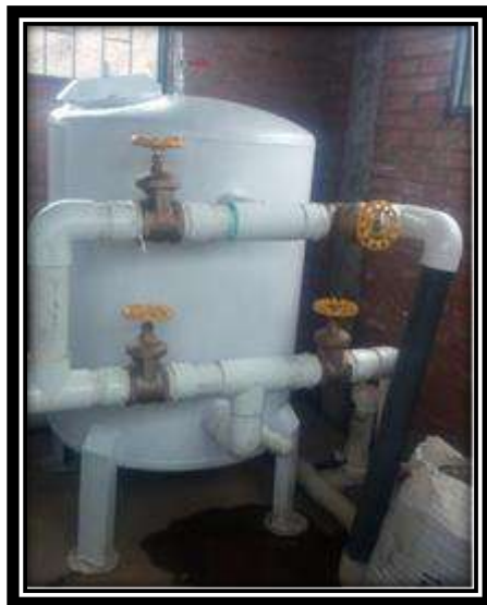
Ilustración 53. Planta de Tratamiento- Sistema Aguas Claras
