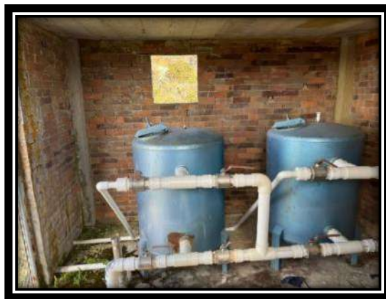
Ilustración 79. Planta de Tratamiento existente Acueducto Veredal Plan de Sumapaz
