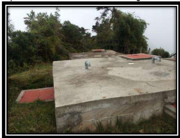
Ilustración 55. Tanque de Almacenamiento- Sistema Aguas Claras- Vereda La Unión
