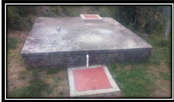
Ilustración 49. Tanque de Almacenamiento- Sistema San Juan
