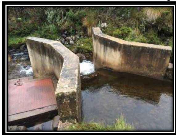
Ilustración 57. Bocatoma Quebrada Honda- Sistema Amigos del Páramo
