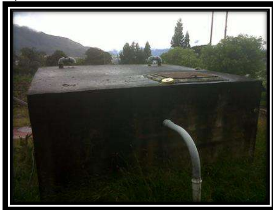
Ilustración 24. Tanque de almacenamiento existente Acueducto ASOPERABECA II
