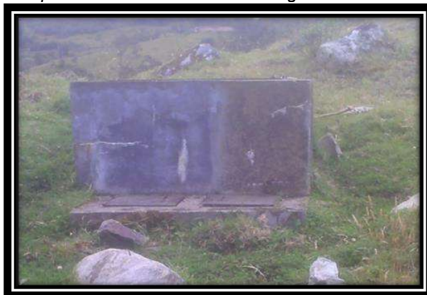
Ilustración 35. Tanque de Almacenamiento Pedregal- Acueducto Veredal ASOUAN
