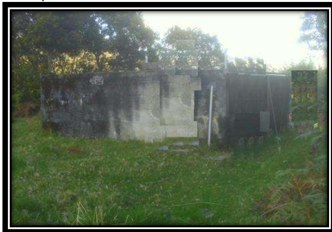
Ilustración 37. Tanque de Almacenamiento Nazareth- Acueducto Veredal ASOUAN
