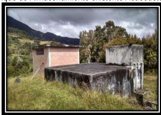
Ilustración 19. Tanque de Almacenamiento existente Acueducto ASOPERABECA I
