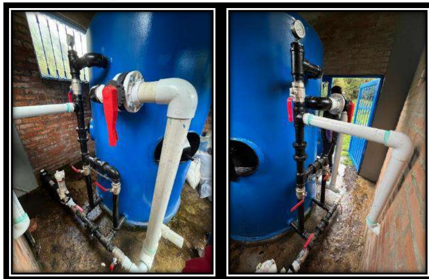
Ilustración 40. Planta de Potabilización existente Acueducto Veredal
