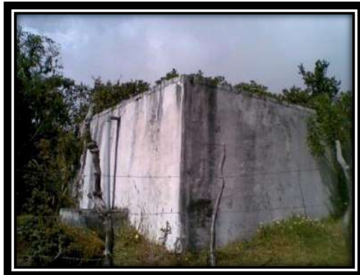
Ilustración 14. Tanque de Almacenamiento Acueducto Veredal ASOMEDIANARANJA
