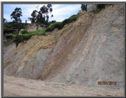
Fotografía No. 11. Industrias Gresqui Ltda. Panorama del frente afectado norte.
